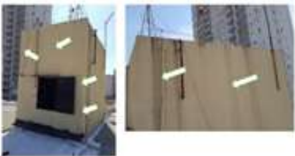
Fig. 7 - Podemos observar, na foto de cima, a falta de uma grade de proteção na saída de água do reservatório, por falta de reforço.
