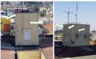
Fig. 5 - E' possível ver a falta de reforço em uma grande área da estrutura, causada por falhas de execução durante a obra. Isso pode ser a consequência de falhas de execução de obras, ocasionadas pela falta de reforço nos ângulos do reservatório.
